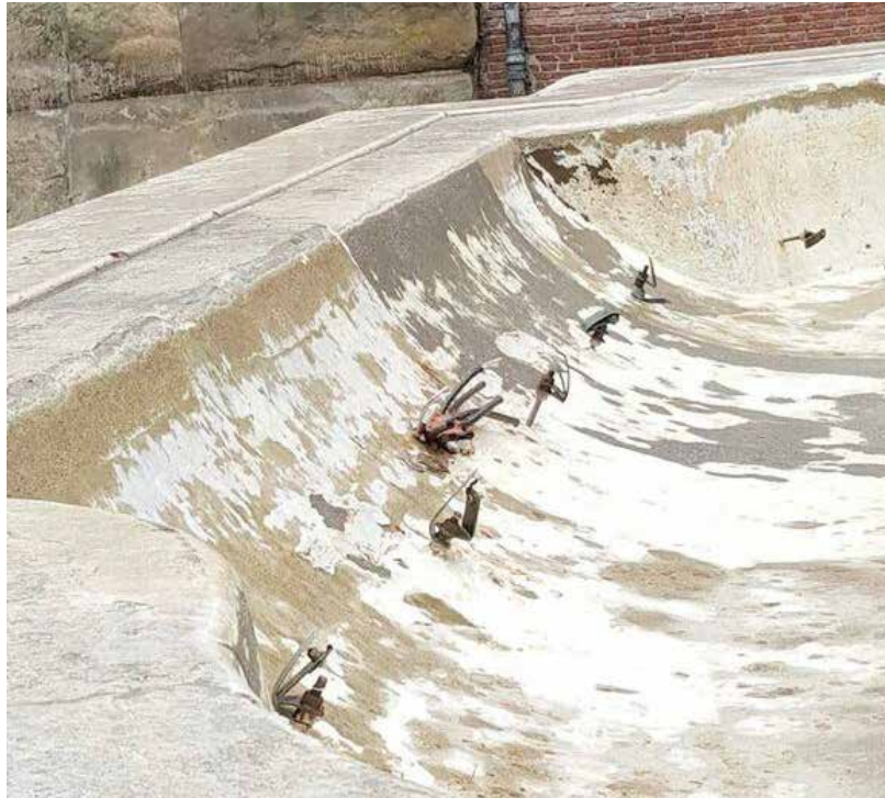
Figura 2: Impianto di illuminazione immerso nella vasca principale della fontana del Nettuno
