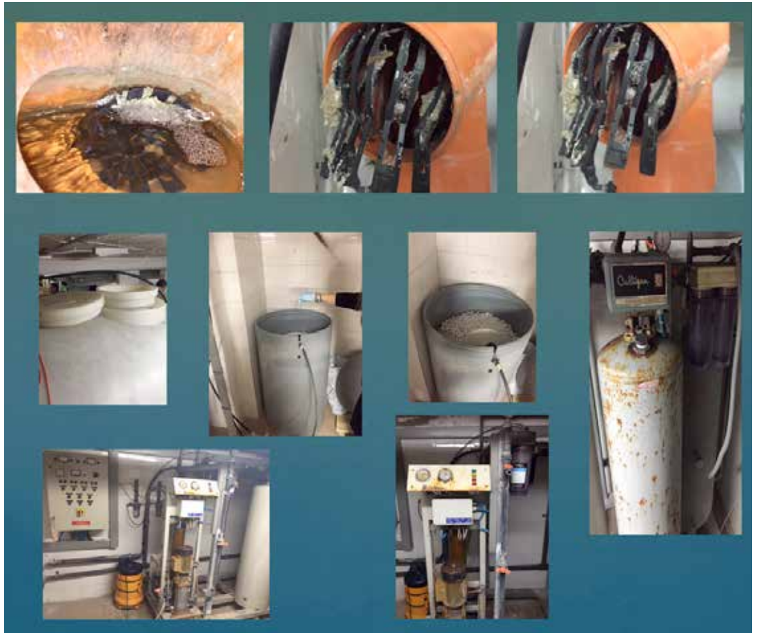
Stato di deterioramento del sistema idrico (vani tecnici)
