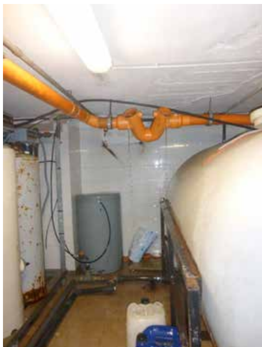
FIGURA 1 sx: Condotta dell'acqua di ritorno dalla fontana.
